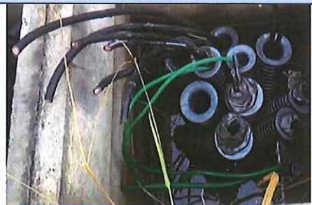
▲引き抜かれた状況
