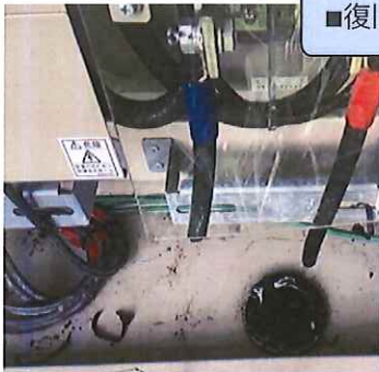
▲切断された状況
